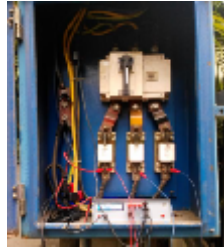
Gambar 4. Penempatan alat pada box panel PHB-TR
